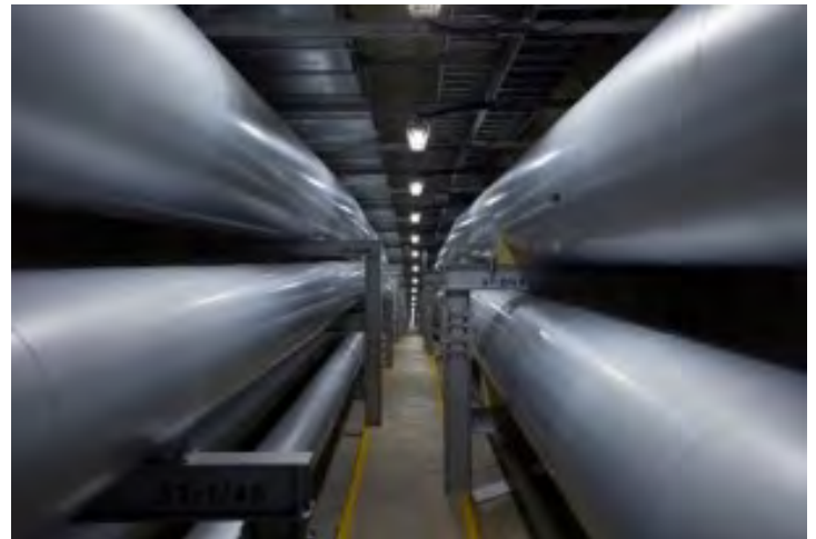
熱を供給する地下配管
