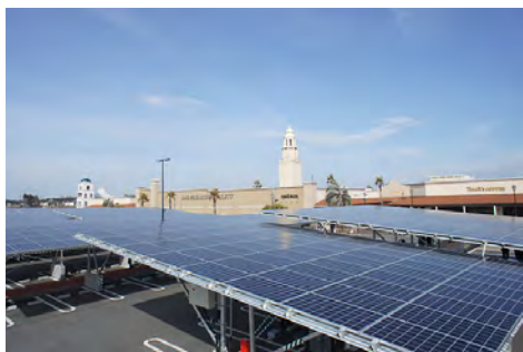
自家消費用カーポート型太陽光発電設備 （あみプレミアム・アウトレット）
