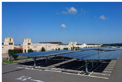
自家消費用カーポート型太陽光発電設備 （酒々井プレミアム・アウトレット）
