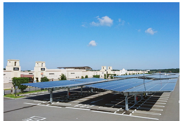
酒々井プレミアム・アウトレット 自家消費用カーポート型太陽光発電設備
