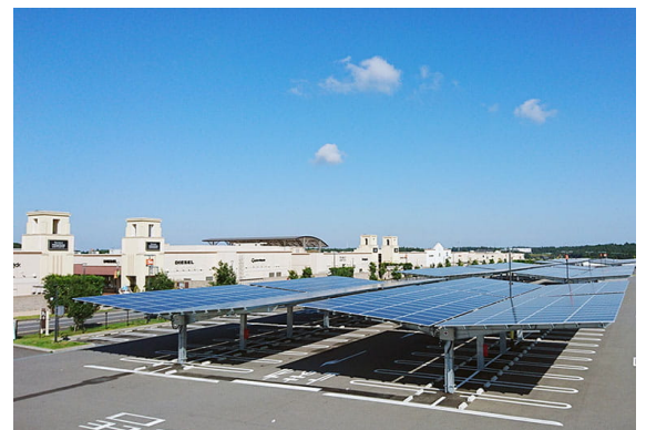
酒々井プレミアム・アウトレット 自家消費用カーポート型太陽光発電設備
