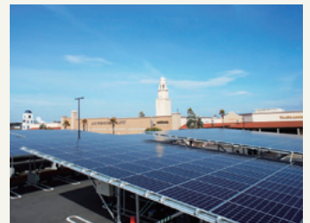
あみプレミアム・アウトレット 自家消費用カーポート型太陽光発電設備
