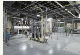
汚水の浄化施設
