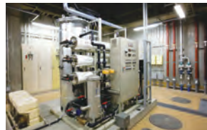
非常災害用地下水揚水設備
