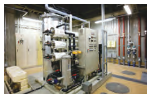
非常災害用地下水揚水設備
