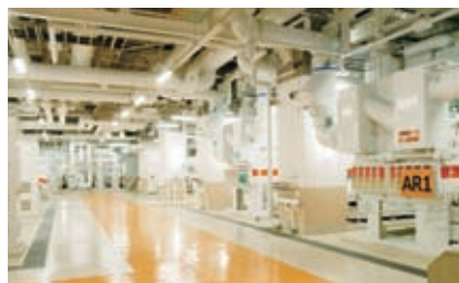
「丸の内パークビル」の地下に設けた最新プラント(丸の内熱供給)
