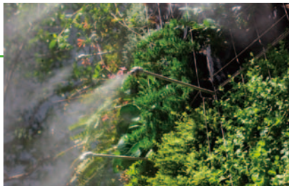
丸柱のドライミスト 気温が上昇すると自動的にドライミストを噴射し、噴霧気化熱により周辺温度を下げます。
