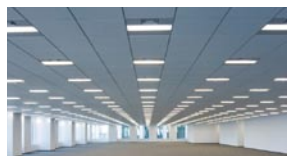
超高効率型照明 反射板の形状・塗装などを工夫し、消費電力を抑えた照明を採用
