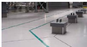
クールルーフ 屋上に遮熱塗料を塗布し、日射による室内温度上昇を低減
