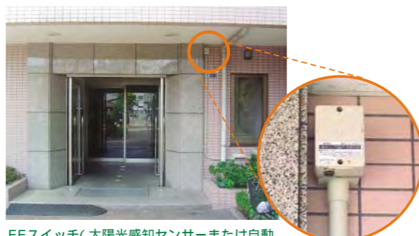
EEスイッチ(太陽光感知センサーまたは自動点滅器)取り付けによる使用電力量削減の例: マンション玄関に取り付けたEEスイッチにより、24時間点灯していた駐輪場、駐車場の照明(蛍光灯40W×11本)を昼間は消灯し、夜間など暗くなった時に一定の明るさで点灯するように制御することで点灯時間を削減しました。
