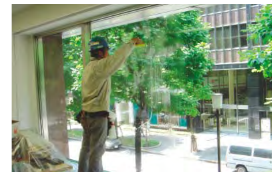
ガラス飛散防止フィルム貼付状況
