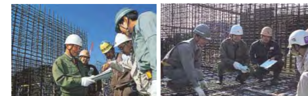
工事のクオリティをさらにアップさせる施工品質管理の「クオリティーインスペクター」
