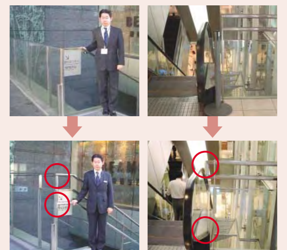
落下防止のため、吹き抜け階の階段手すりのかさ上げを実施しました。背の低い方や高齢者、児童にも使いやすいよう、低い位置にも二重に手すりを設置しています。
