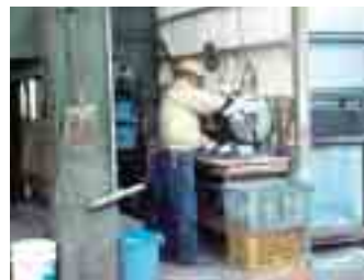
◀廃プラスチック(塩ビパイプ)をリサイクルするためのカット処理状況
