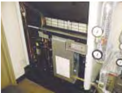
フロン冷媒使用の空調機
