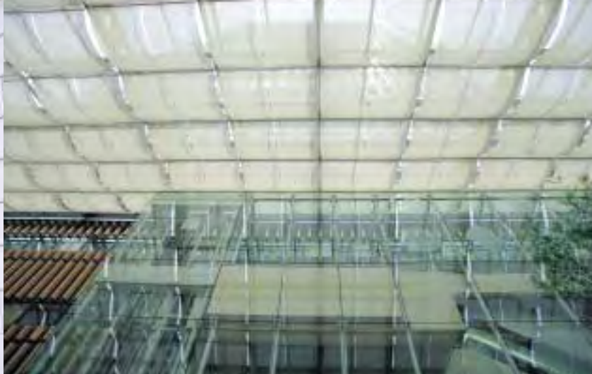
直射日光を遮蔽し、柔らかな光に換えるとともに熱気を上部に留め、自然通風により排出するロールスクリーン
