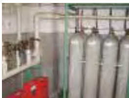
ハロゲン化物消火設備
