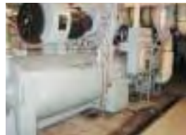
空調用冷凍機
