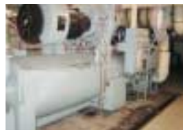
空調用冷凍機
