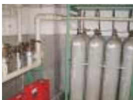
ハロゲン化物消火設備
